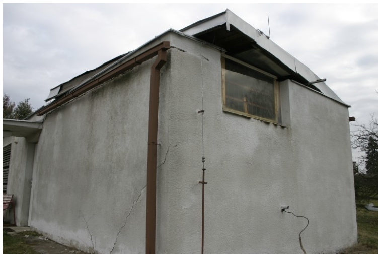
Obr. 1 — Střecha domečku posunutá vichřicí 2. 3. 2008. Foto Jan Veselý.
