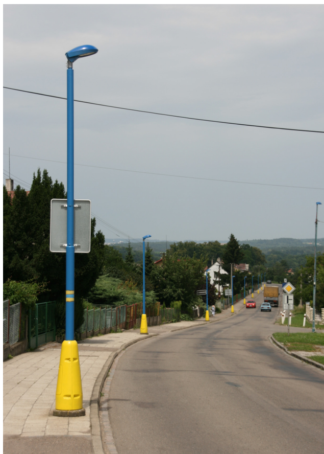
Obr. 11 — Lamy instalované v Jiráskově ulici, směřující do Červeného Kostelce.
